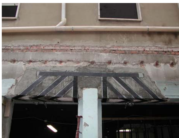
Consolidamento di trave mediante impiego di fibre di carbonio (Impresa IMG srl – Milano)
