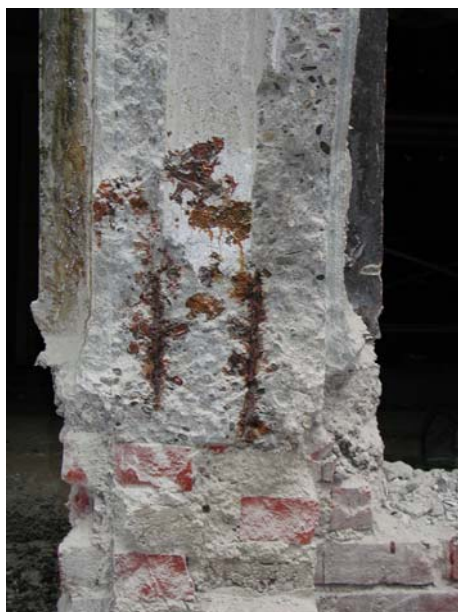
Particolare del pilastro in cls armato semplicemente appoggiato alla muratura sottostante, senza alcun collegamento (Impresa IMG srl – Milano)
